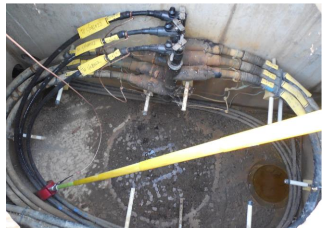
Placement de capteur au-dessus des câbles HTA dans un trou d'homme
