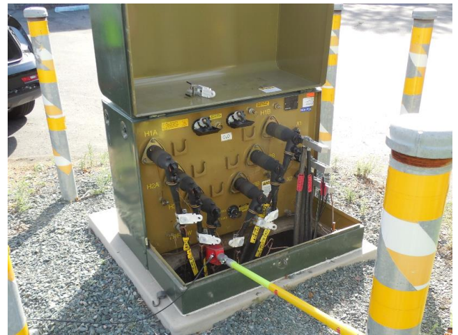
Test de diagnostic sous tension pour des câbles et transformateurs HTA.
